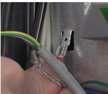
Afscherming van de canbus-kabel
